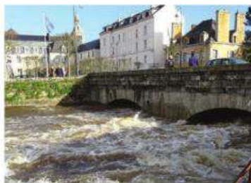
Pont du Bourgneuf lors des crues de 2013/2014 (06/02/2014)
