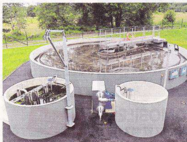
La station d'épuration de Malguénac.
